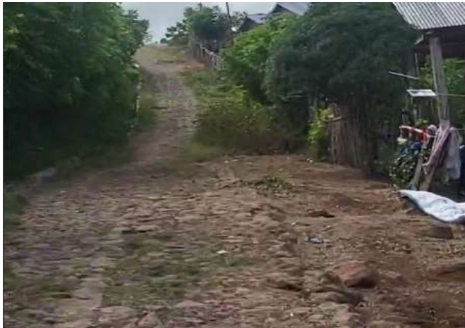
Gambar 4.5 Kondisi Jalan Desa Benteng Dewa
